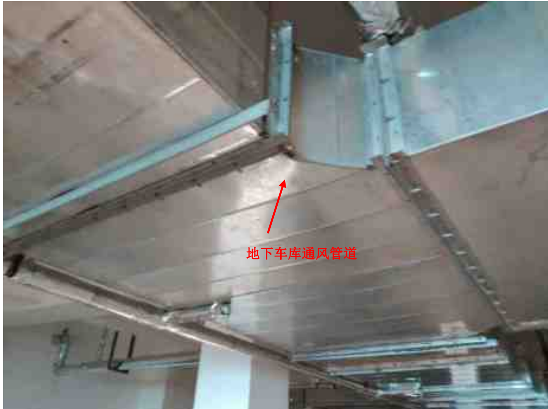
图 4-2 运营期废气治理设施照片
