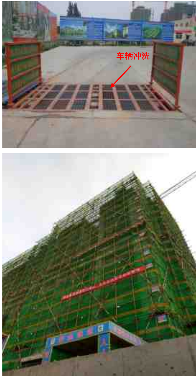
图 4-1 施工期废气治理设施照片
